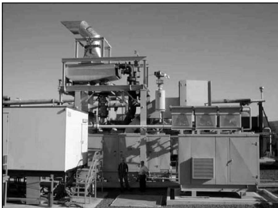
Rys. 8. Gaźnikowa turbina gazowa CGT w kopalni Appin (Assessment of the Worldwide Market...)
